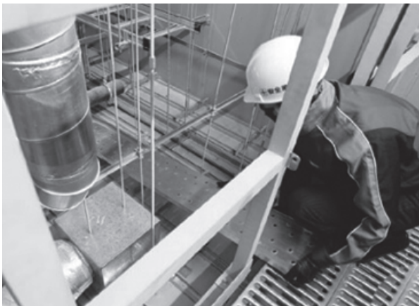
天井裏の構造を模した設備も完備
