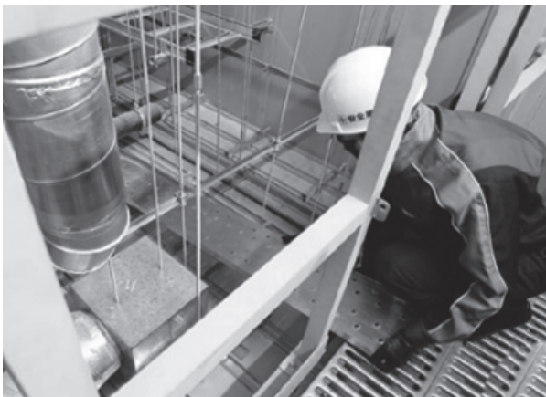
天井裏の構造を模した設備も完備
