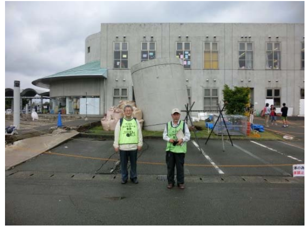
傾いたポンプ塔
