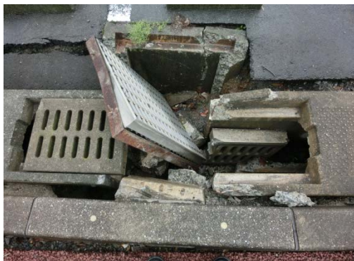
破損した排水溝
